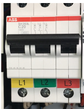
Маркировка фаз на вводе в щит
