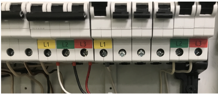
Маркировка фаз на автоматах
